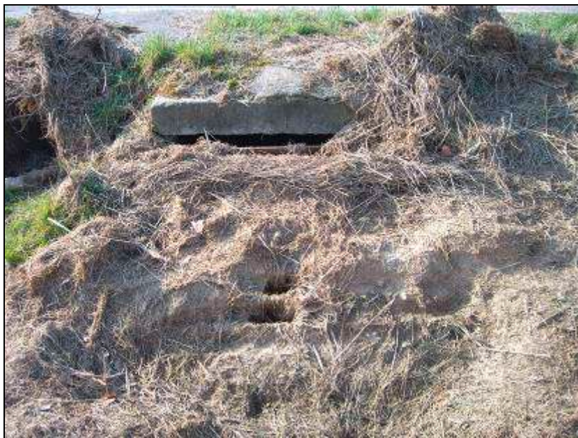
FIG. 10 Griglia con innesto tubazioni di attraversamento della sede stradale spesso otturata da materiale vegetale e terroso
