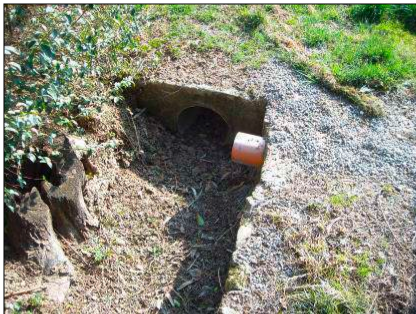
FIG. 44 Particolare tubazione in cls diam 125 mm
