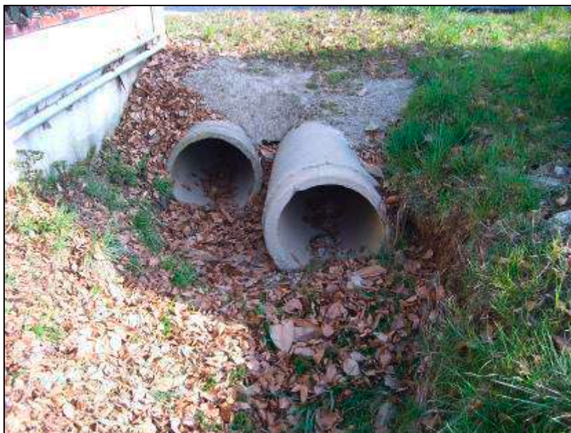
FIG. 12 Tubazioni a valle di via Verdi
