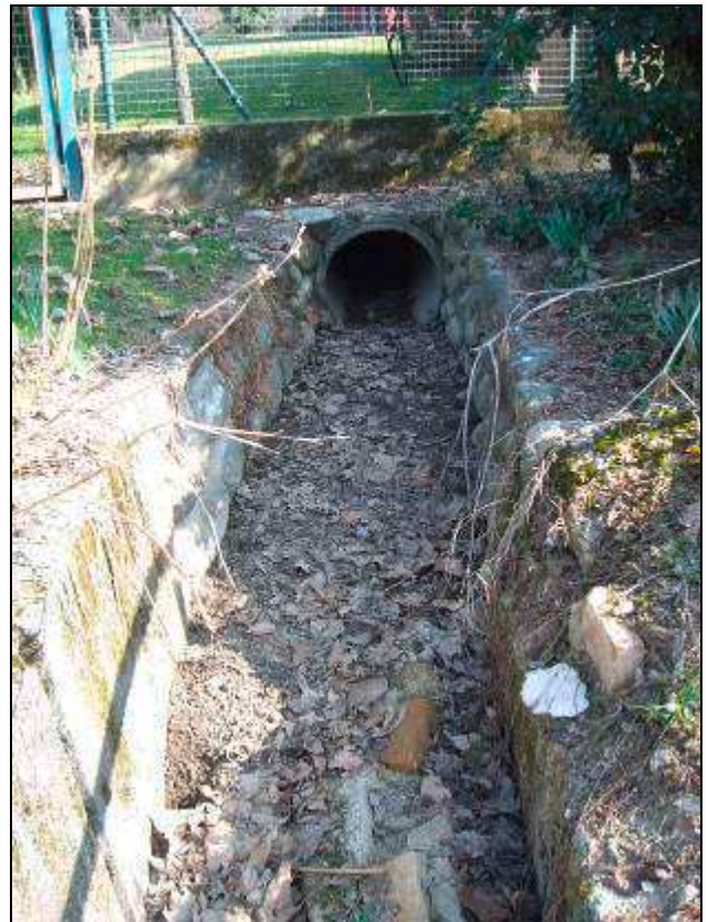
FIG. 41 Particolare tubazione in cls diam 550 mm
