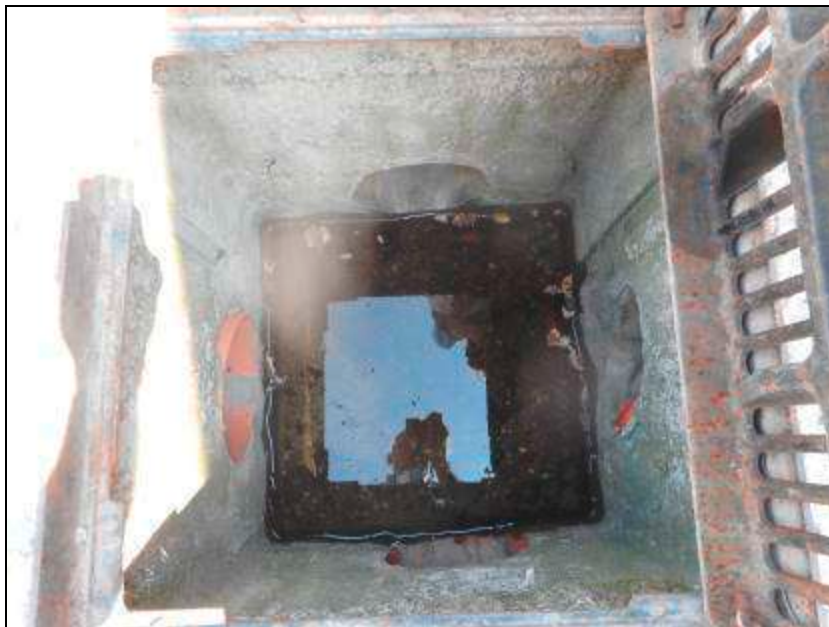
FIG. 48 Particolare Pozzetto griglia raccolta acque da piazzale
