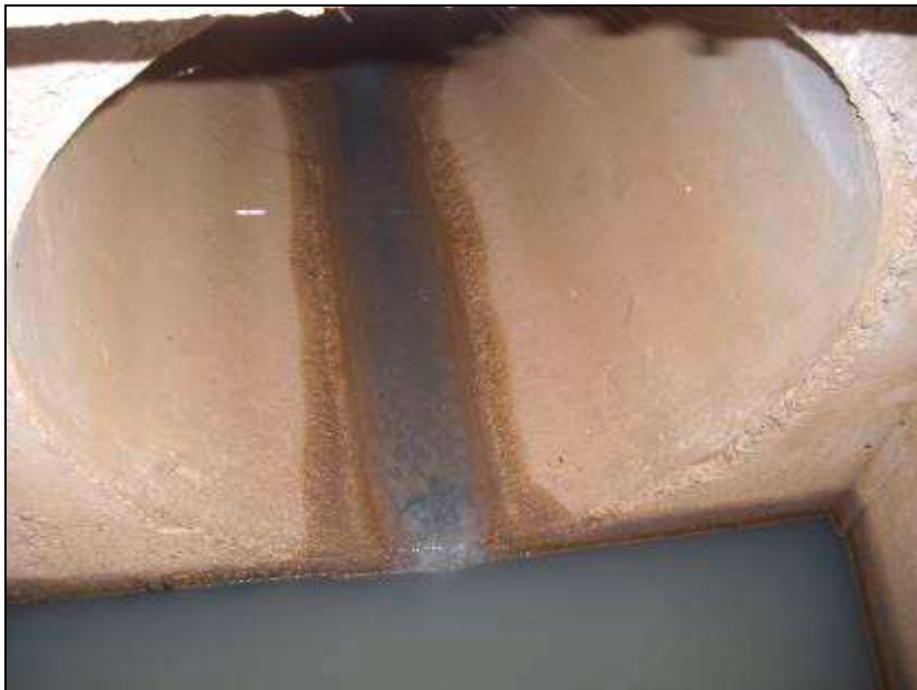
FIG. 37 Particolare tubazione in cls diam 800 mm
