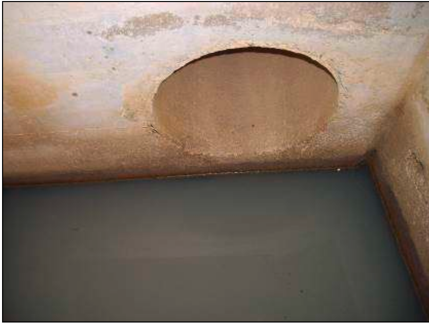
FIG. 36 Particolare tubazione in cls diam 400 mm
