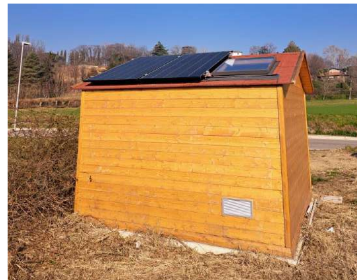
Esterno pozzo, vista impianto fotovoltaico.
