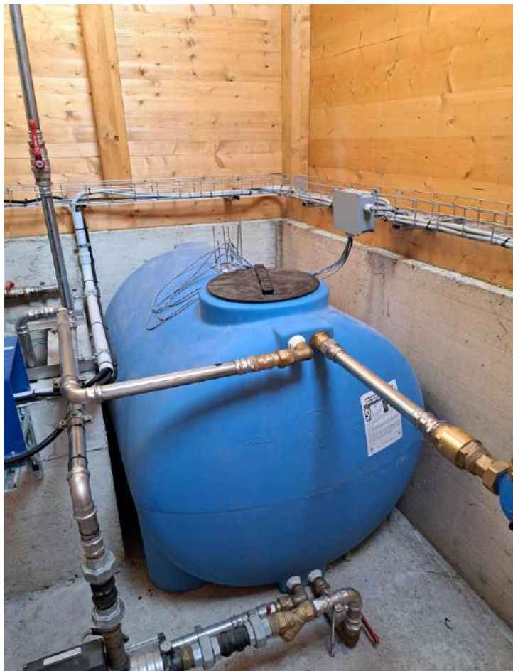
Serbatoio di stoccaggio dell'acqua prelevata dal pozzo.
