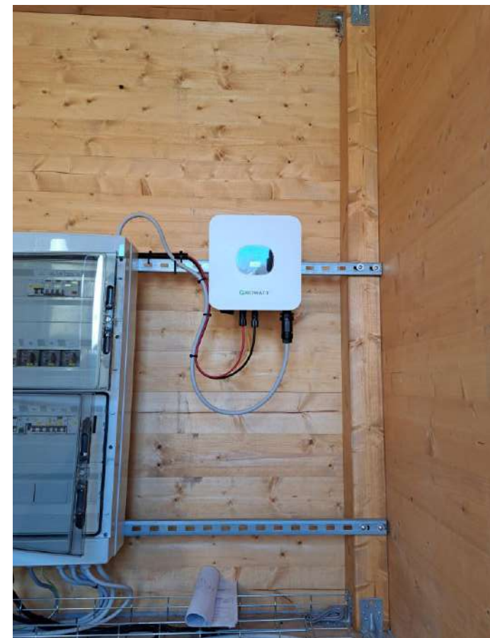
Centralina impianto fotovoltaico.
