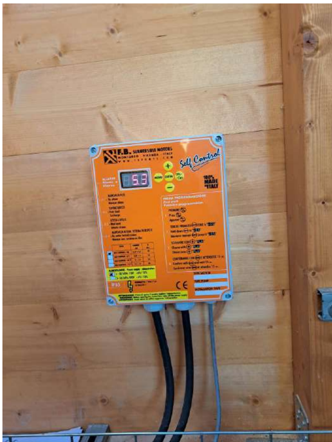
Quadro comandi pompa ad immersione.
